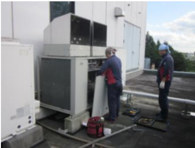
フロンガス定期点検
